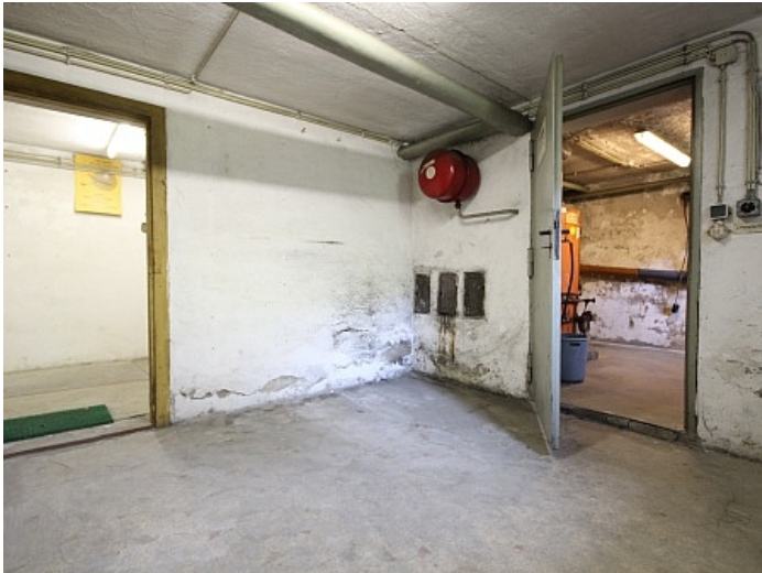
Wohnhaus/Sanierungsbedürftig in bester Lage
