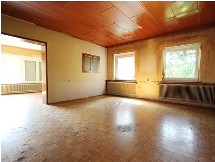
Wohnhaus/Sanierungsbedürftig in bester Lage
