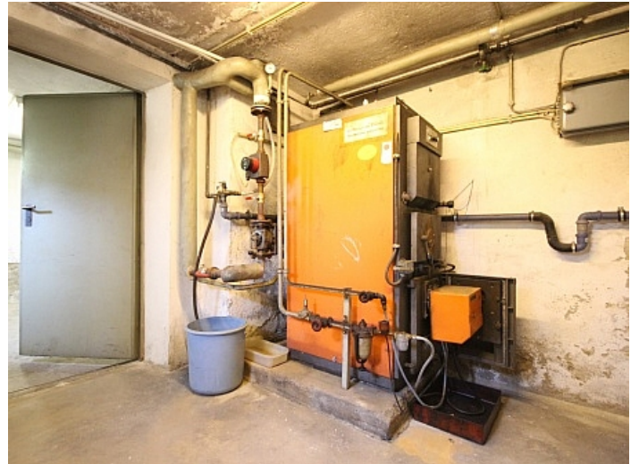
Wohnhaus/Sanierungsbedürftig in bester Lage
