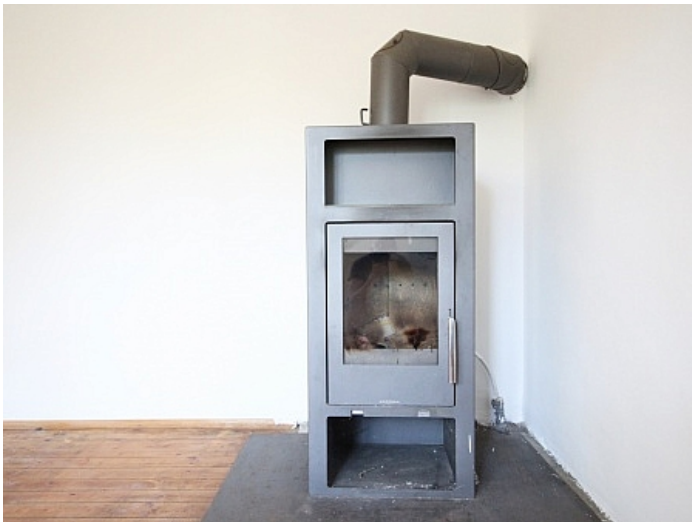
Heizung / Ofen im Erdgeschoss
